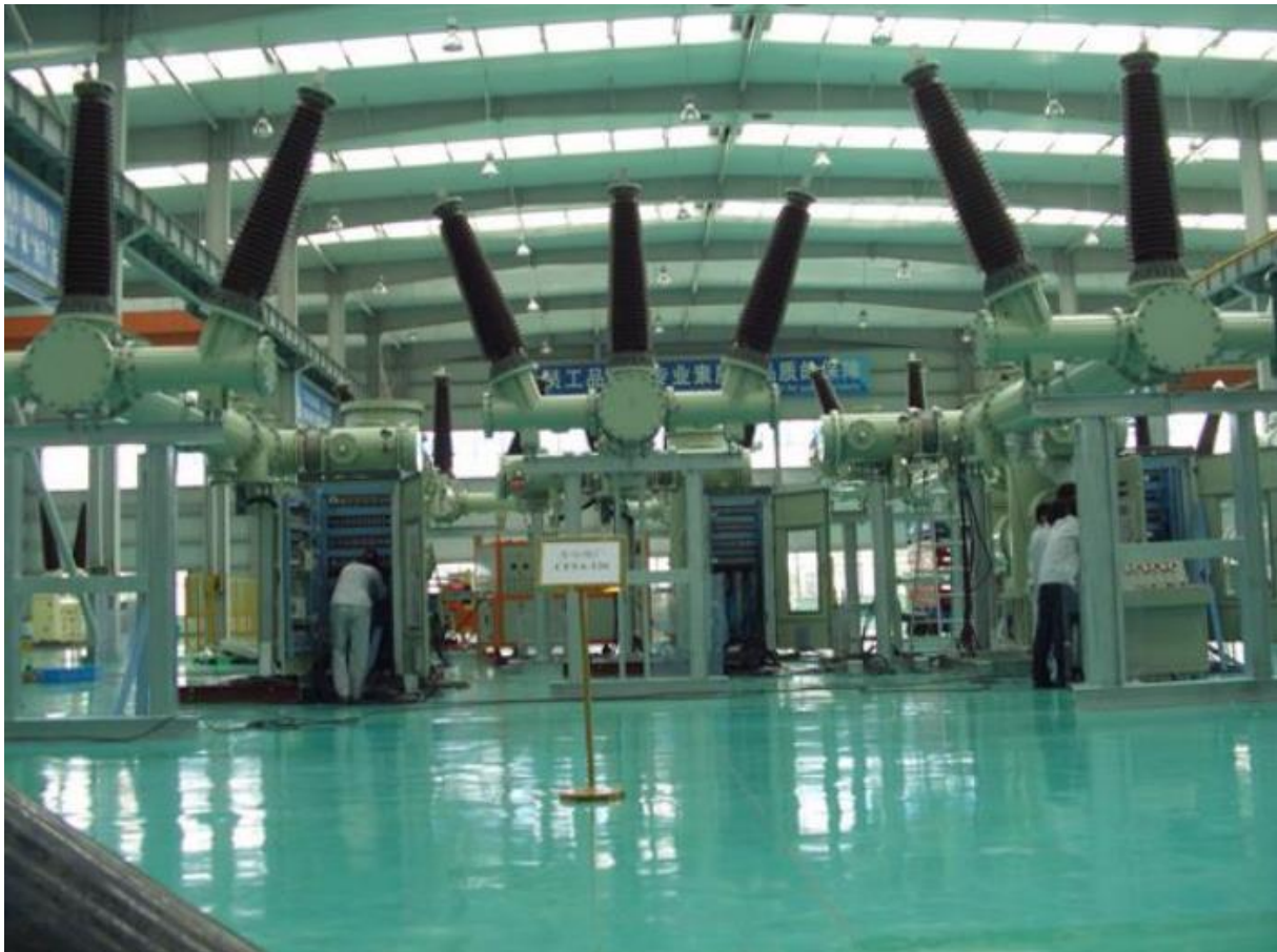
Figure 1.3: poste du type abrité [4]
