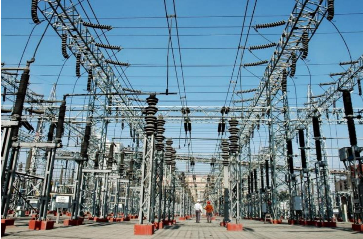
Figure I.2: poste du type extérieur [4]
