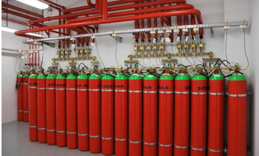
Figurell.8. Image des systèmes d'extinction automatiques fixe à gaz [Wikipédia].
