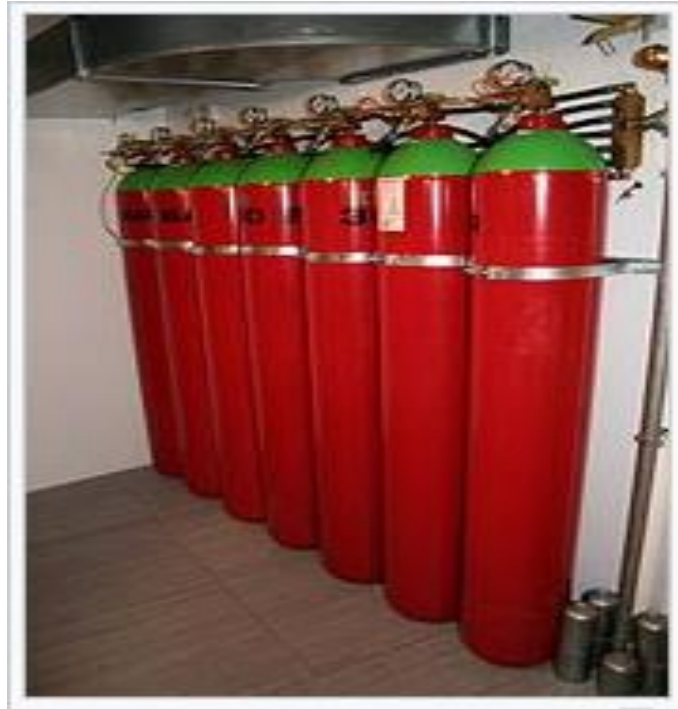
Figurell.6. Image d'argon dans un Datacenter[Wikipédia].
