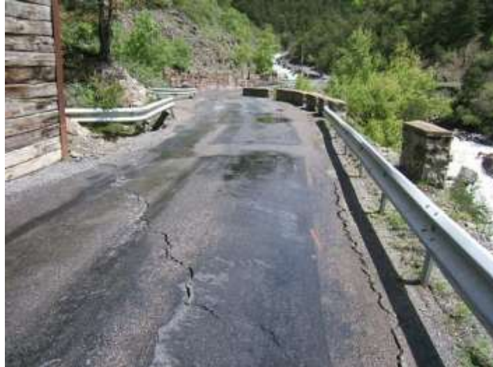
Figure I.4. Dégradation progressive de la chaussée [3]
