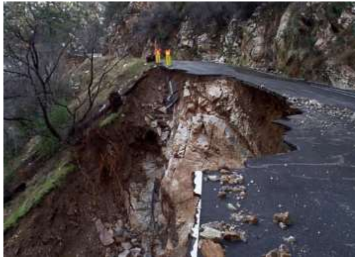
Figure I.6. Effets induits par l'eau sur les dépendances routières [3]
