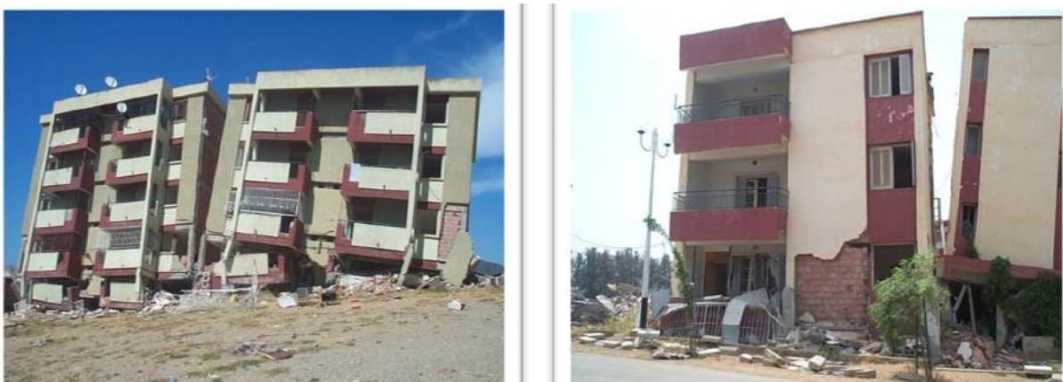
Figure 6. Insuffisance de la largeur du joint entre les blocs de bâtiments [6].
