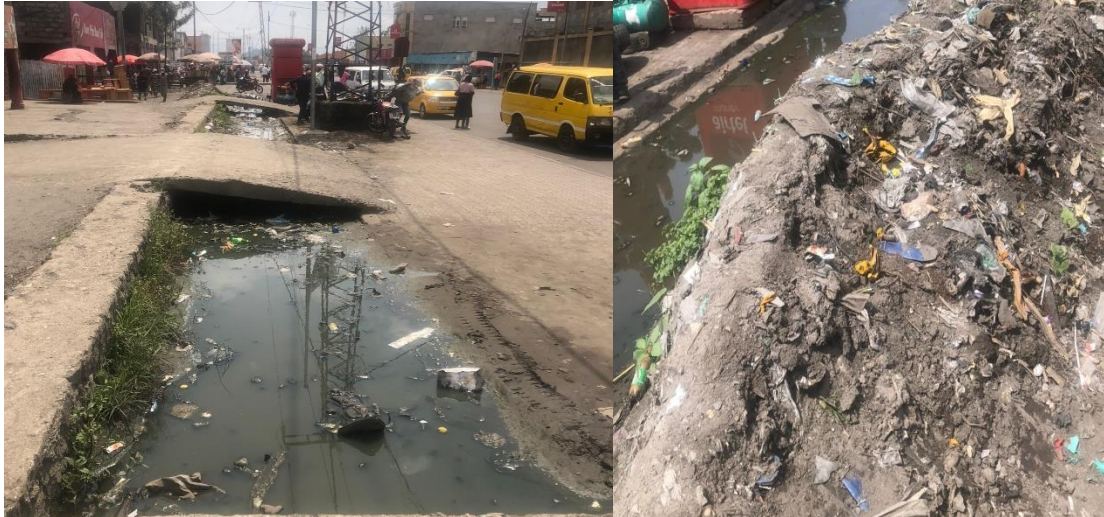
Figure 8: Représentation des dégradations au niveau de AFIA BORA dues en l'insuffisance des ouvrages d'assainissement sur notre tronçon.
