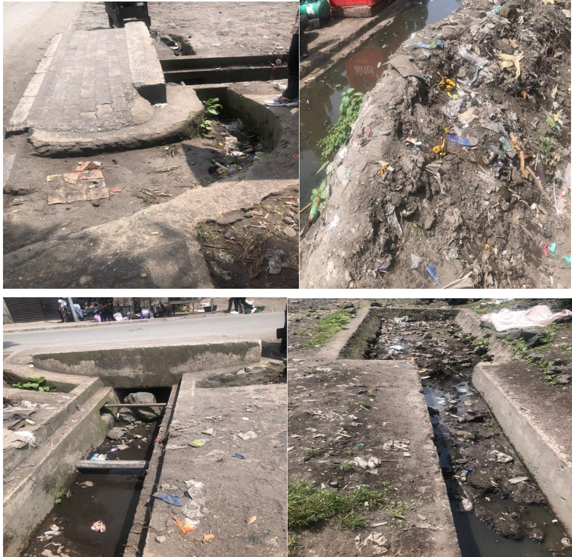
Figure 6: les différents dégradations des ouvrages d'assainissements observées sur notre tronçon
