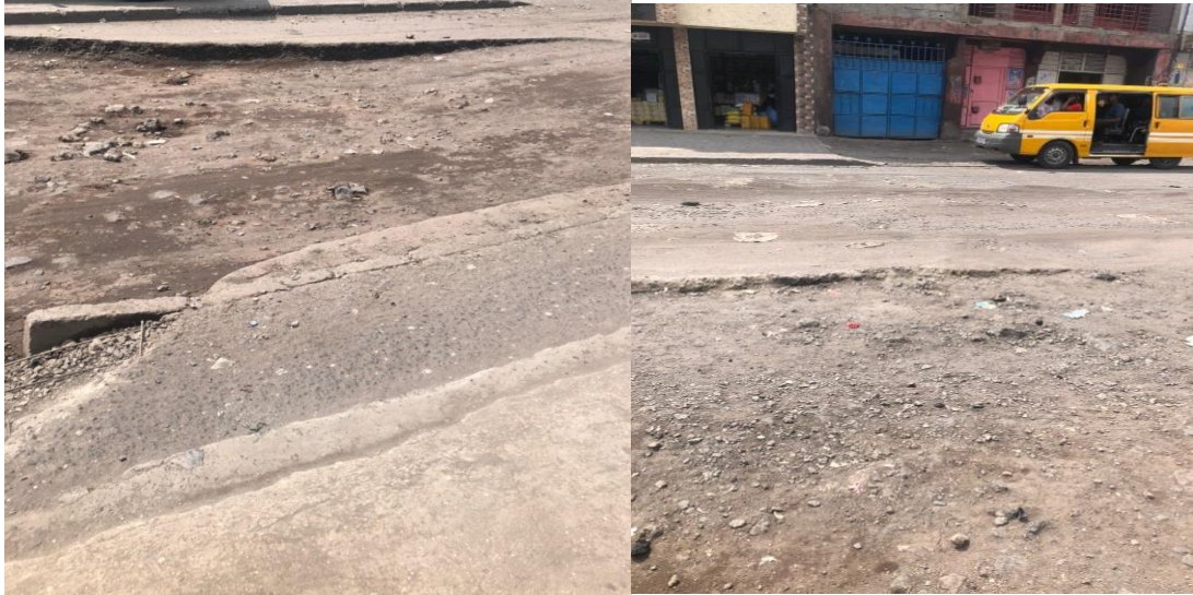
Figure 5: dégradation due au tassement de corps de chaussée
