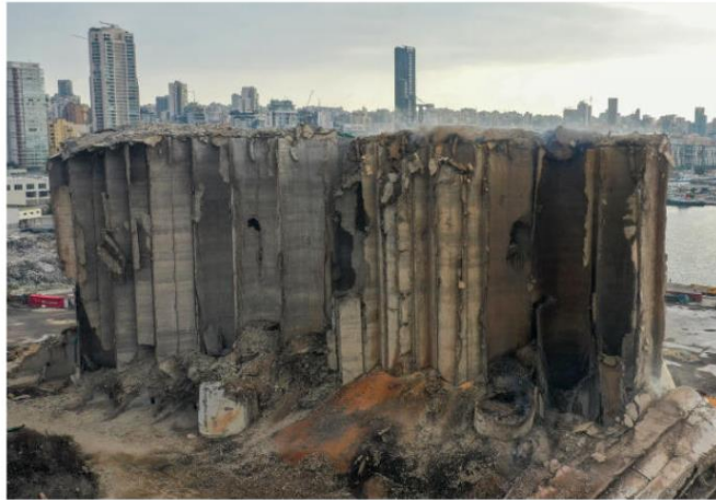
Figure 19: groupe de silo détruit par une explosion [22]
