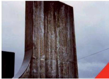
Figure15.Efflorescences sur un mur en béton soumis à la pluie après décoffrage [31]
