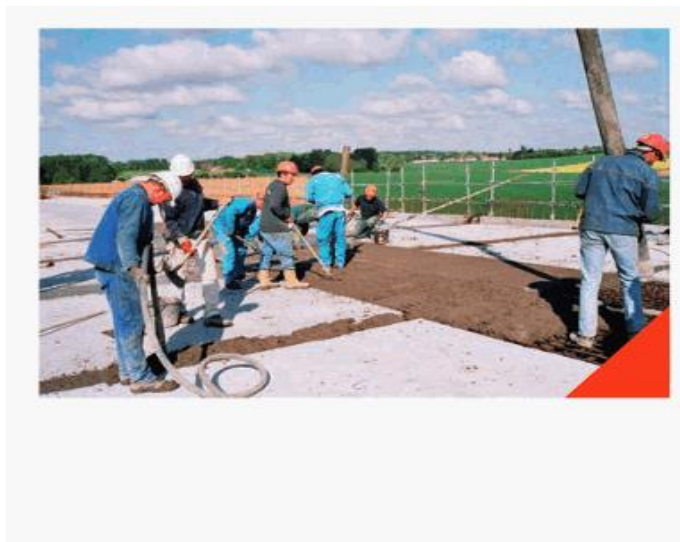
Figure 8. Brèches de clavages coulés ultérieurement lors de la réalisation d'une dalle [31].
