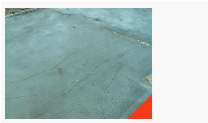
Figure 10. Fissures de retrait plastique, dues à l'absence ou la mise en œuvre trop tardive de cure [31].
