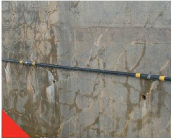
Figure 18. Pile massive d'un point atteint de réaction sulfatique interne. Le béton a subi une température de 80 °C durant plus de 200 heures [31].
