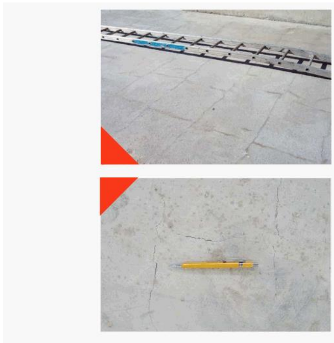
Figure 9. Réseau orthogonal de fissures de tassement (vue globale et détail) [31]
