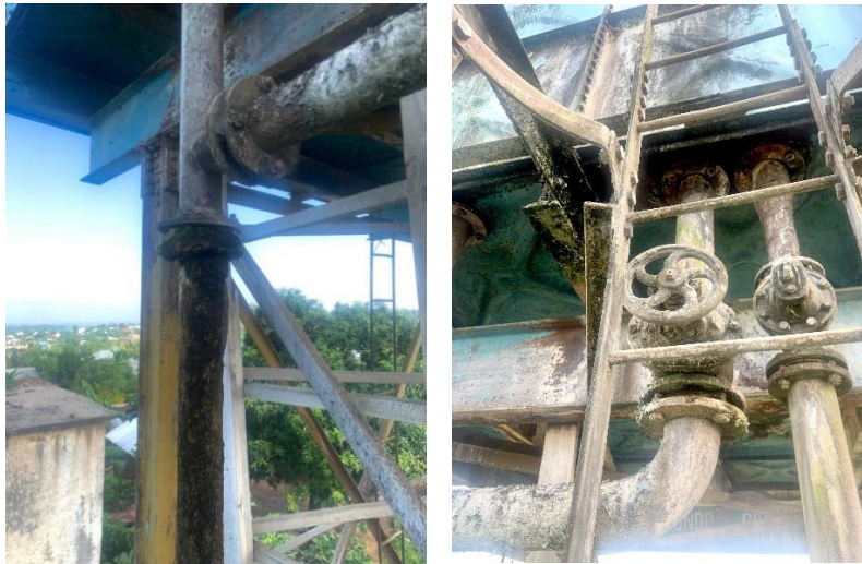
Figure 2.3 : vannes et conduite corrodées
