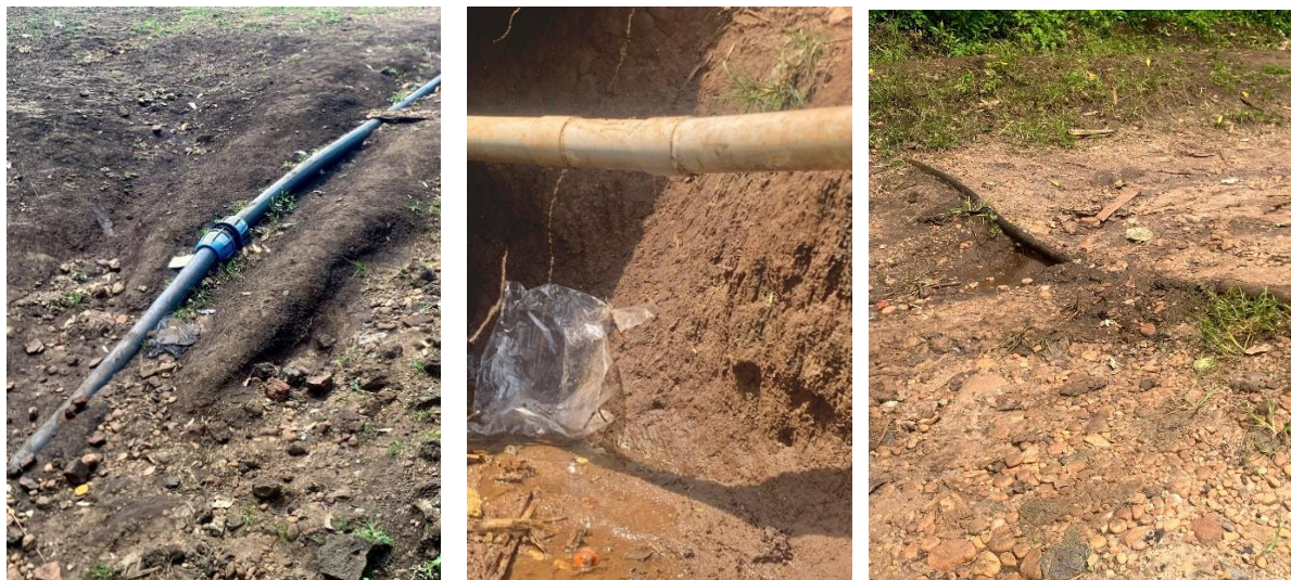
Figure 2.5 : Etat actuel des conduites de distribution
