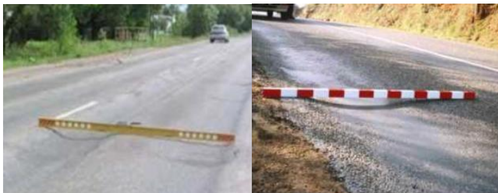
Figure 1.9: Exemple des déformations d'orniérage [5]
