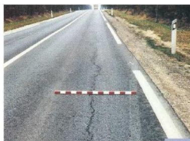
Figure 1.13 : Exemple d'une fissure longitudinale [5]
