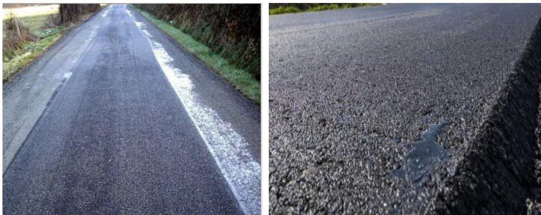
Figure 1.19 : Exemple des remontées sur le revêtement bitumineux [5]
