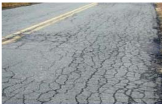
Figure 1.14 : Faïençage moyen sur une chaussée [5]
