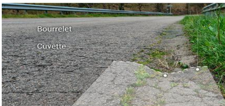
Figure 1.8: Exemple d'un affaissement de rive [5]
