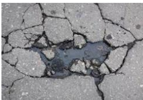
Figure 1.18 : Exemple d'un pelage dans la chaussée [5]
