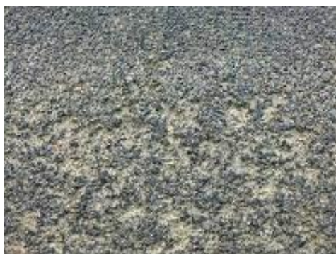
Figure 1.17 : Exemple d'un plumage sur une chaussée [5]
