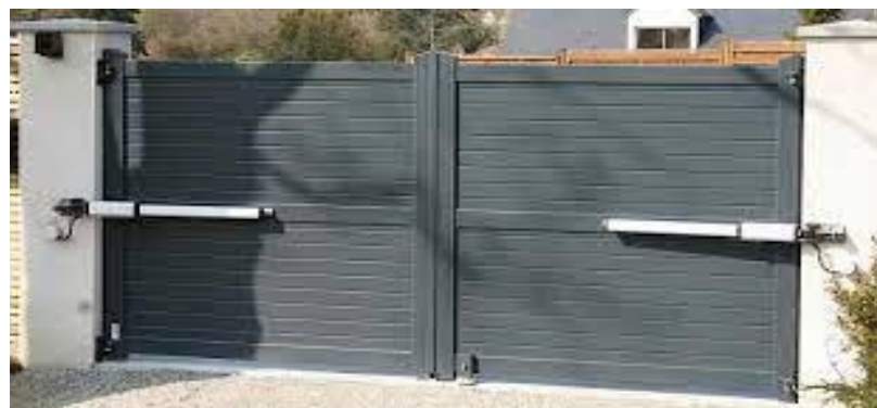
Figure 1.7 : motorisation à vérins [9]
